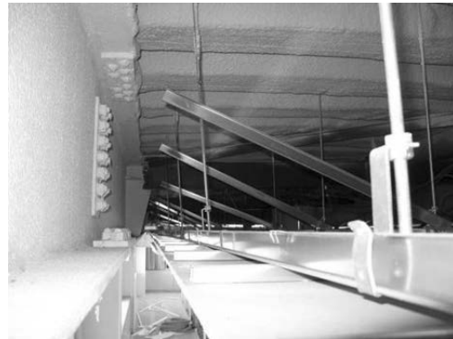
写真 2.4 斜め部材の溶接部の破断
