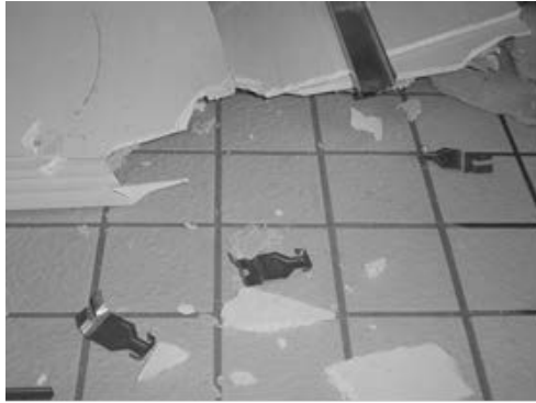
写真 2.1 クリップの損傷・外れ
