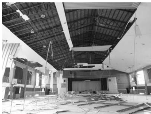
写真 1.1 体育館（在来工法の天井）の被害
