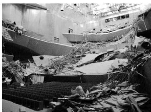
写真 1.3 大規模ホールの被害
