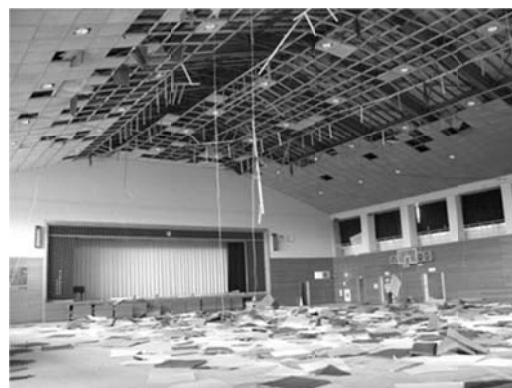
写真 1.2 体育館（システム天井）の被害
