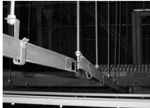
写真 2.2 野縁受けジョイントの外れ
