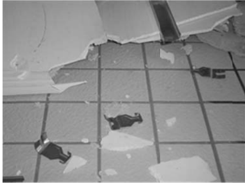
写真 2.1 クリップの損傷・外れ
