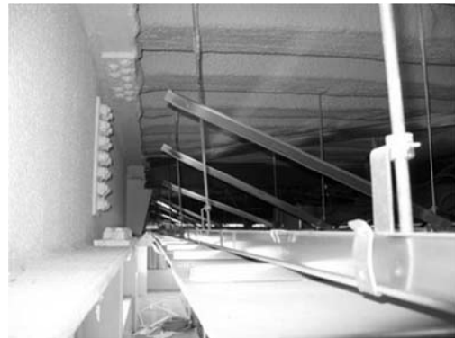
写真 2.4 斜め部材の溶接部の破断
